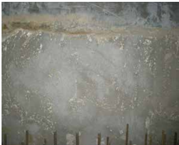
Рисунок 2. Незачищенный шов между верхней и нижней частью стены в грунте
