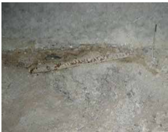
Рисунок 3. Коррозия оголенной арматуры
