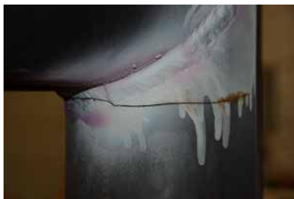
Рисунок 3. Усталостная трещина в ЭУ таврового соединения
