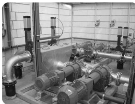
Рис. 20.2. Насосная станция для подачи навоза в метантэнк
