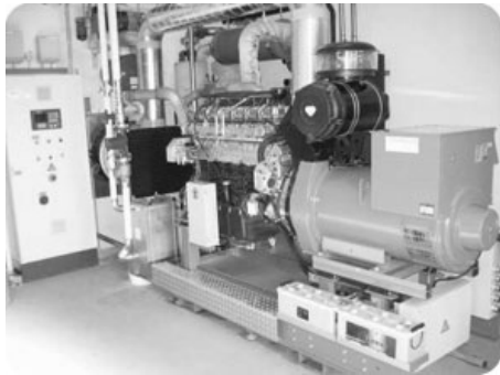
Рис. 20.7. Модуль КГУ мощностью 200–300 кВт
