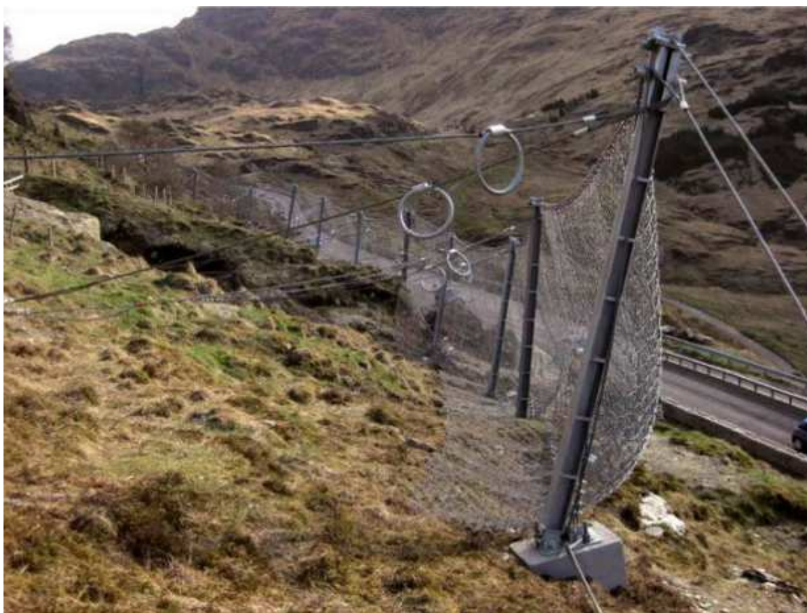
Рис. 2. Общий вид гибкого противокамennого барьера
