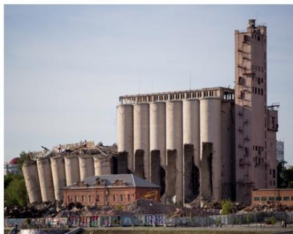
Рис.2. Обрушение элеватора Екатеринбургского мукомольного завода
