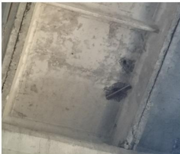
Рис. 3. Выбоины в районе плит покрытия
