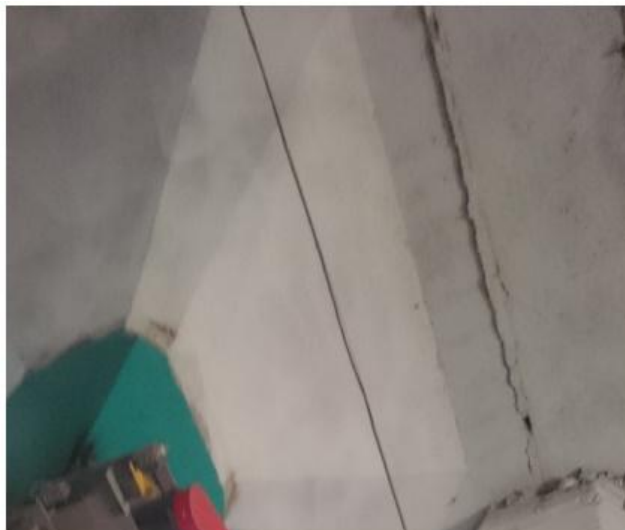
Рис. 4. Выветривание швов (Кат. В)
