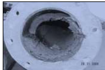
Рис. 2 - Отложения в приемном шланге УБН-3 месторождения «Дракон», Вьетнам
