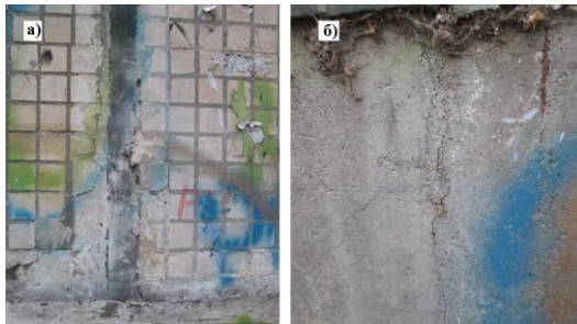
Рис. 1. Эксплуатационный износ панельных жилых зданий:
