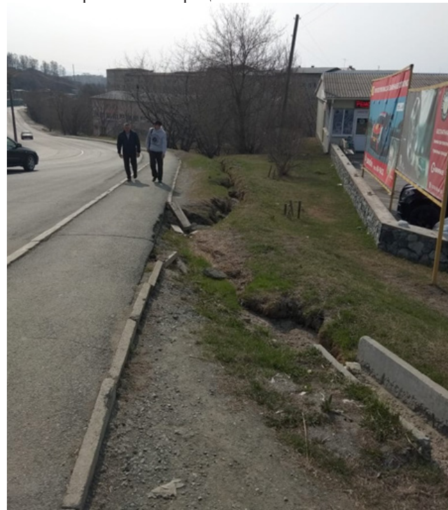
Рисунок 2 – Эрозионная борозда разрушающая тротуар
